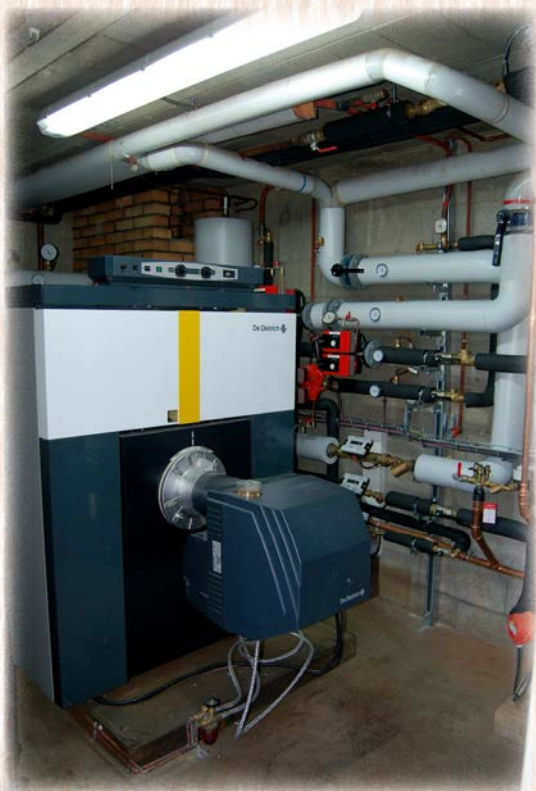
Le chauffage de la salle est programmé par télégestion depuis la mairie.
